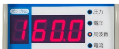
運転周波数表示 (例: 1号ポンプ 60Hz)
