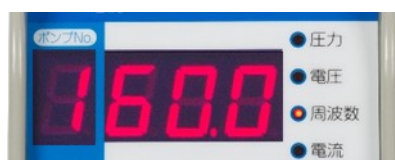
運転周波数表示 (例: 1号ポンプ 60Hz)
