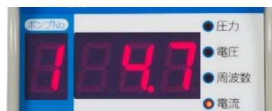
電流表示 (例: 1号ポンプ 4.7A)
