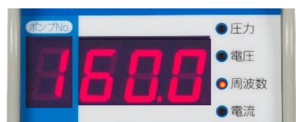
運転周波数表示 (例: 1号ポンプ 60Hz)
