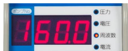
運転周波数表示 (例: 1号ポンプ 60Hz)
