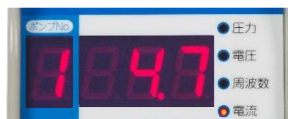
電流表示 (例: 1号ポンプ 4.7A)
