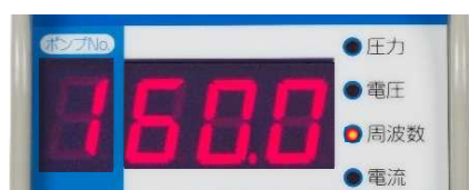
運転周波数表示 (例: 1号ポンプ 60Hz)
