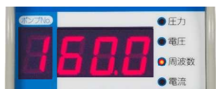
運転周波数表示 (例: 1号ポンプ 60Hz)
