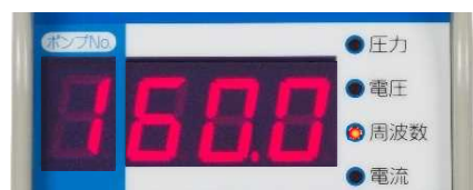
運転周波数表示 (例: 1号ポンプ 60Hz)
