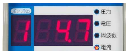
電流表示 (例: 1号ポンプ 4.7A)
