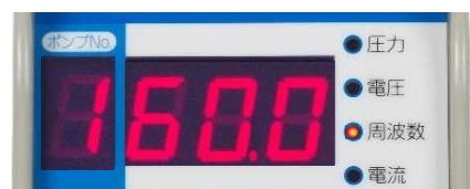
運転周波数表示 (例：1号ポンプ 60Hz)
