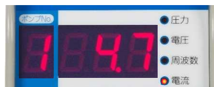
電流表示 (例：1号ポンプ 4.7A)
